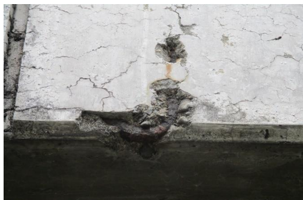
（外壁鉄筋の露出 鬼北町広見保健センター）
