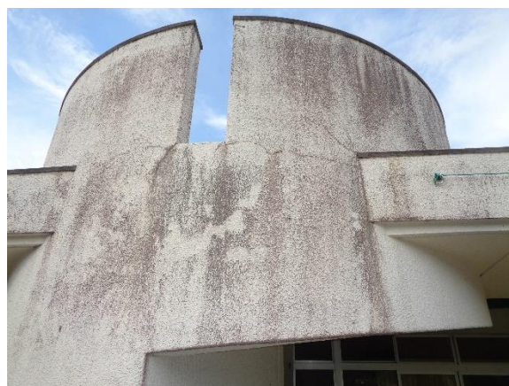
（外壁亀裂 旧好藤保育所）
