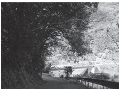
〈法面から張り出した樹木〉
