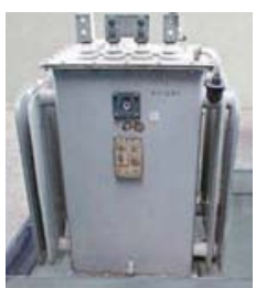
高圧トランスの例
