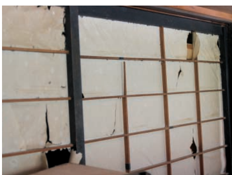
爆風で壊された障子の棧。折れていない箇所にも、至るところにヒビが入り、その爆風の衝撃を伝えている
