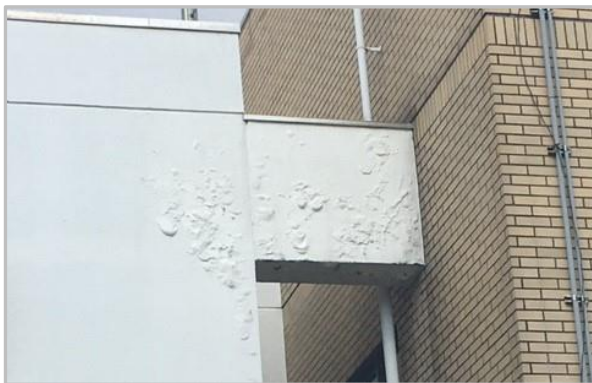
(外壁劣化 鬼北町防災センター)
